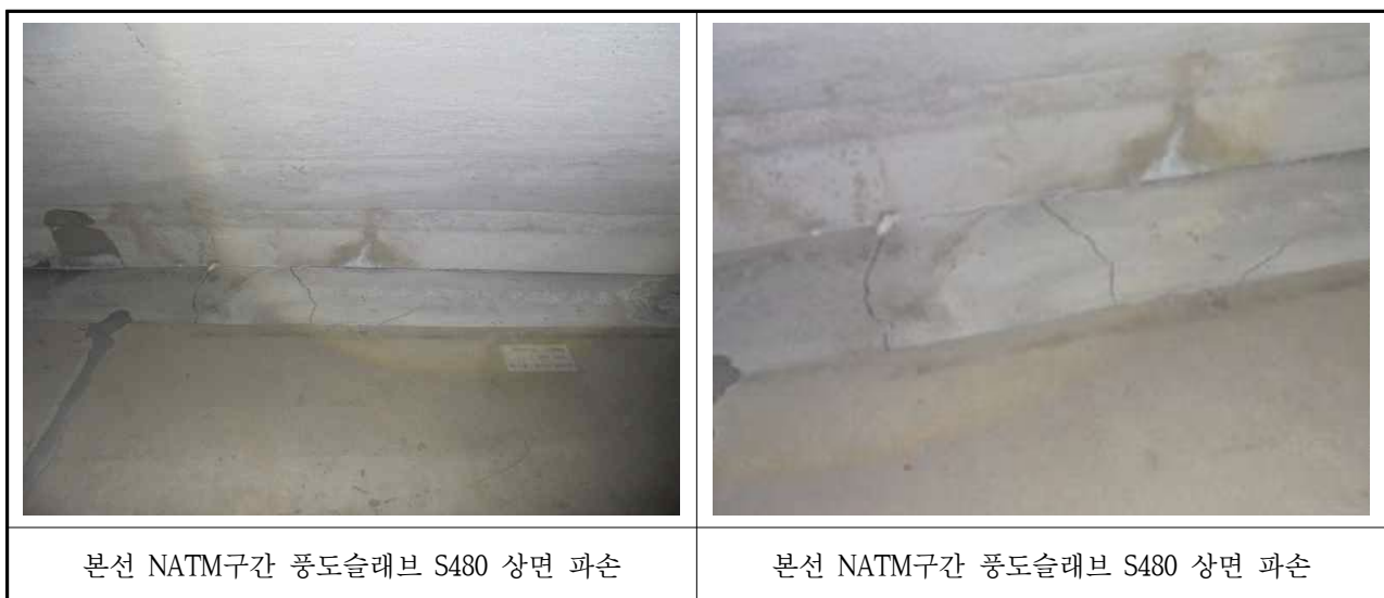
【사진 3.3.10】 NATM구간 풍도슬래브 손상현황
