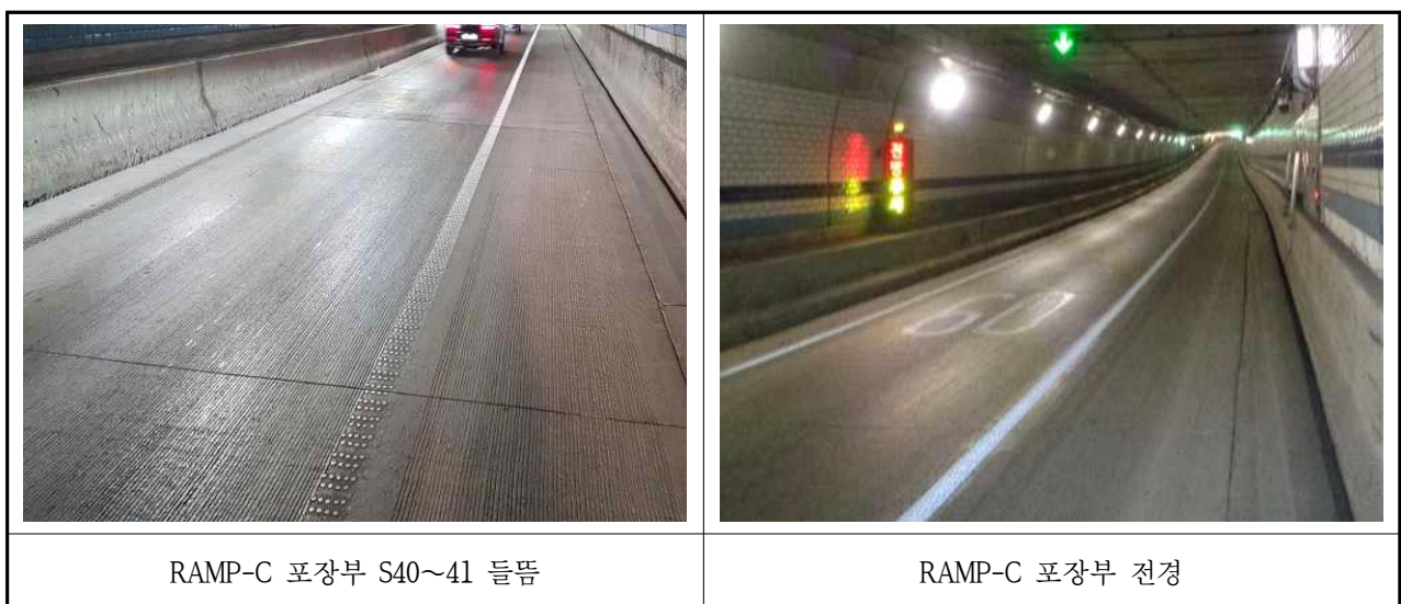
【사진 3.3.30】 포장부 손상현황
