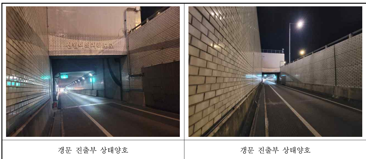
【사진 3.3.36】 갯문 손상현황
