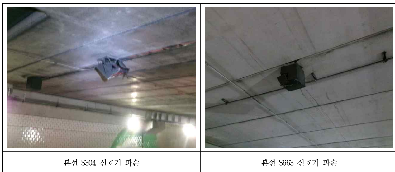
【사진 3.3.46】 기타시설 손상현황
