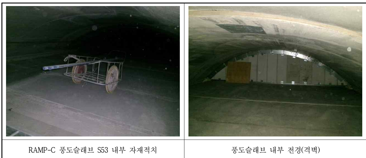
【사진 3.3.28】 NATM구간 풍도슬래브 손상현황
