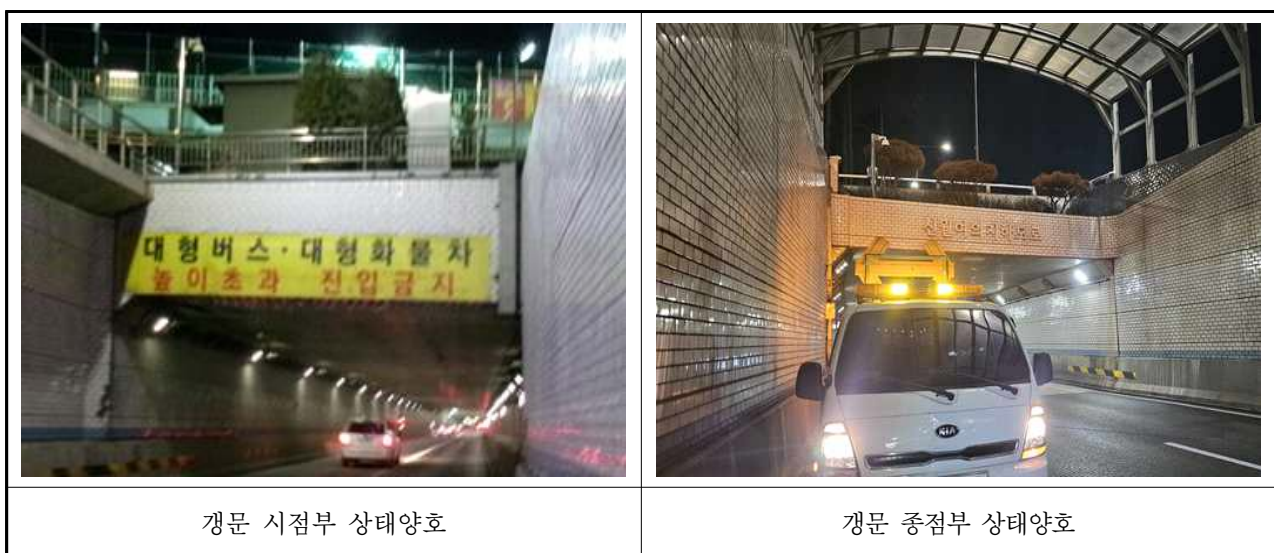
【사진 3.3.18】갯문 손상현황
